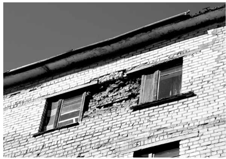
Некоторые отремонтированные по госпрограмме здания вновь требуют реконструкции, а жильцы этих домов еще не рассчитались за предыдущий ремонт. Фото автора
