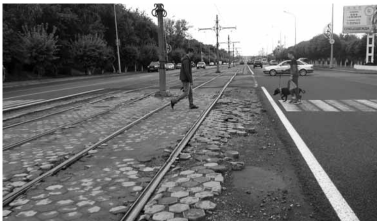
Дороги в Темиртау приводят в порядок, но проблему разбитых трамвайных путей еще предстоит решить. Фото автора
