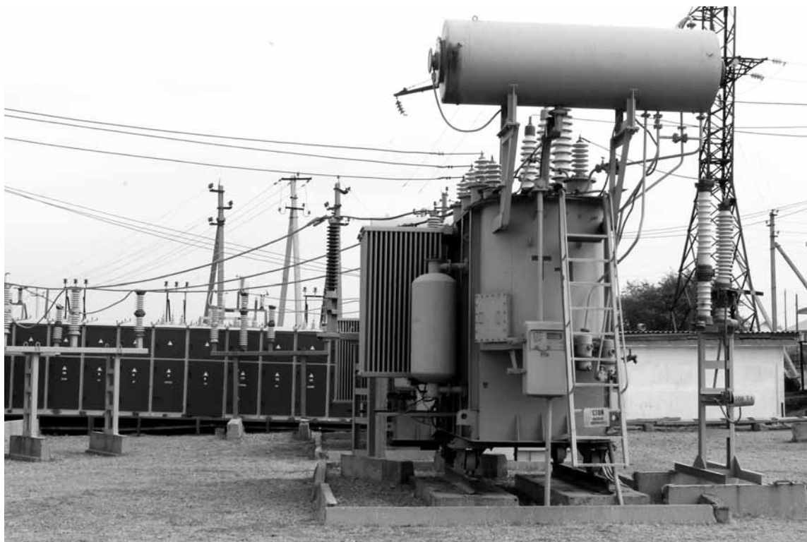
Современную электрическую подстанцию, мощности которой хватает, чтобы обеспечить электроэнергией большой микрорайон, может обслуживать один оператор. Фото автора
