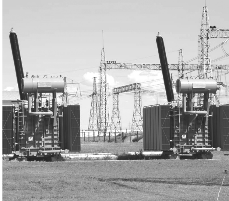
Шунтирующий реактор 500 кВ общей мощностью 180 МВАр производства ТОО «Азия Трафо» (входит в состав АО «Alageum Electric»)
